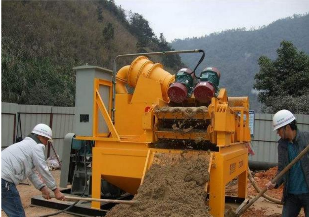
泥浆处理设备
